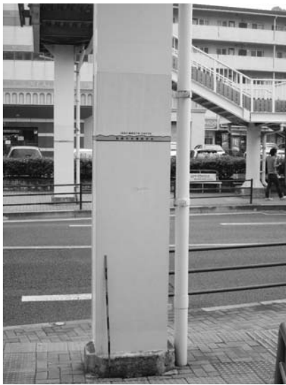
写真8 浸水深に示された歩道橋の橋脚
